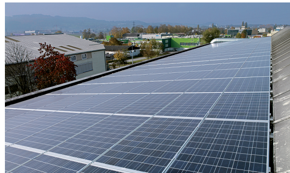
Photovoltaikanlage auf dem Gebäudedach der O. Kleiner AG.
